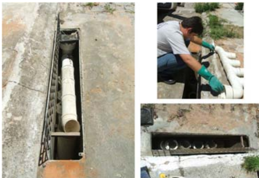
Figura 14 – a) Amostrador composto instalado na sarjeta; b) Detalhe da retirada do tubo vertical no momento da coleta c) Coletores dispostos na sarjeta
